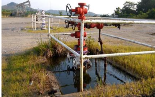
Figura 1. Árbol de válvulas y contrapozo lleno de agua contaminada con residuos.
