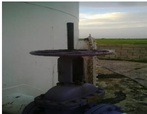
Figura 2. Válvula de control.
