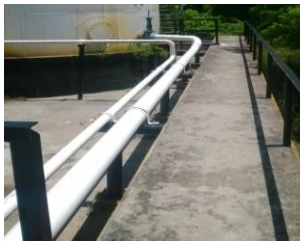
Figura 3. Ductos por donde fluye el crudo.
