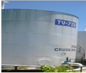
Figura 1. Tanque de almacenamiento.
