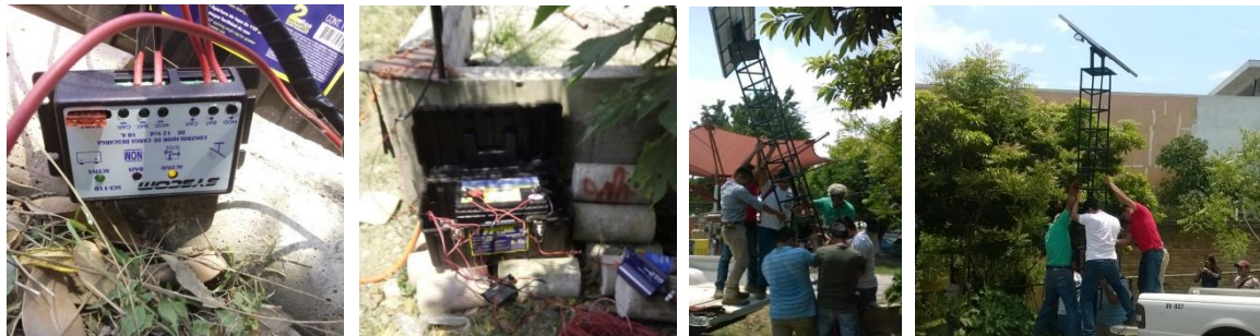
Figura 10, 11, 12, 13. Observamos las conexiones de los circuitos de la celda solar y como se instaló la celda solar dentro de la facultad. Fuente: Morales 2016.
