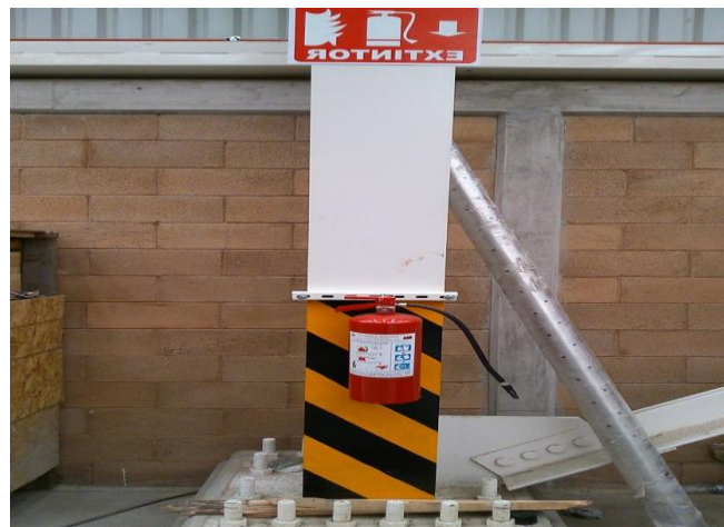
Figura 4. Ejemplo de la colocación de extintores dentro de la planta en lugares estratégicos.
