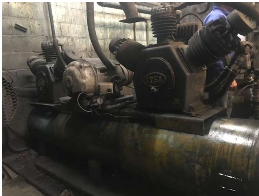
Figura 3. Vista del Compresor ITSA
